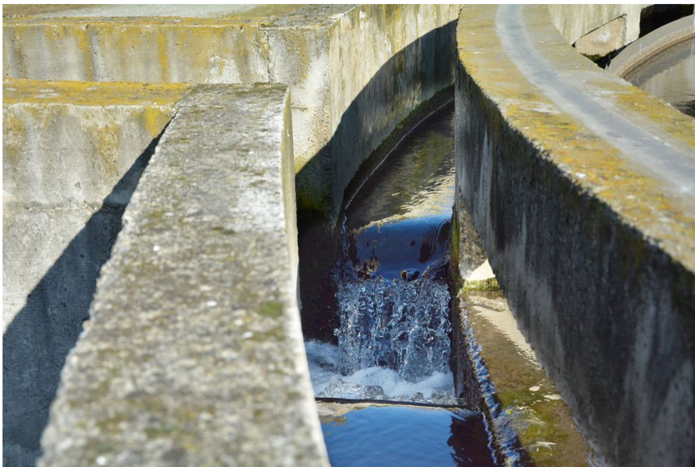
Lo scarico finale del depuratore di Olginate
